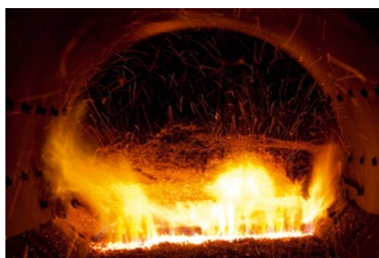
Planta de incineración
